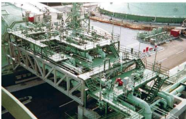
LNG storage facility
